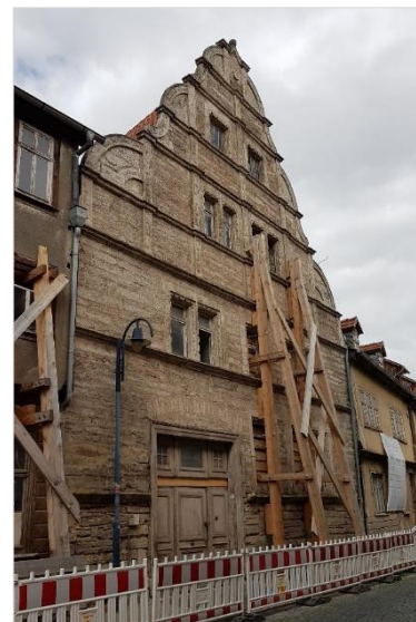
Abbildung 105: Sanierungsbedarf und Gebäude in Sicherung Wahlstraße 69 (Quelle: ProjektStadt 2021)
