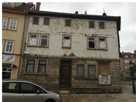
Abbildung 107: Sanierungsbedarf am Steinweg 41
