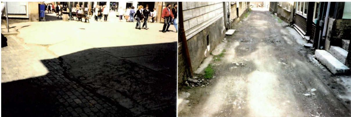
Abbildung 75: Sanierungsbedürftige Verkehrsflächen Altstadt Mühlhausen (Quelle: Städtebauliche Kurzanalyse, 1991)
