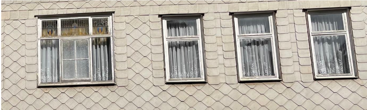
Sanierungsbedürftige Fenster im Bürgerhaus Grabe
