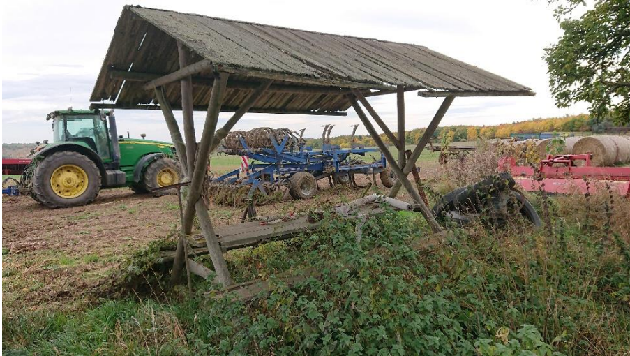
Waldschänke am Feldrand zweckentfremdet und mit Sanierungsstau, Saalfeld
