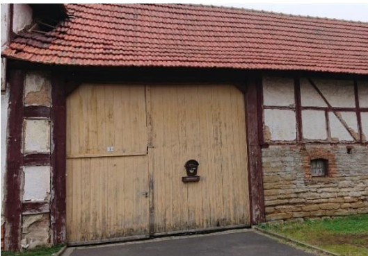
Grabe Holztore mit Sanierungsbedarf in Fachwerkhäusern
